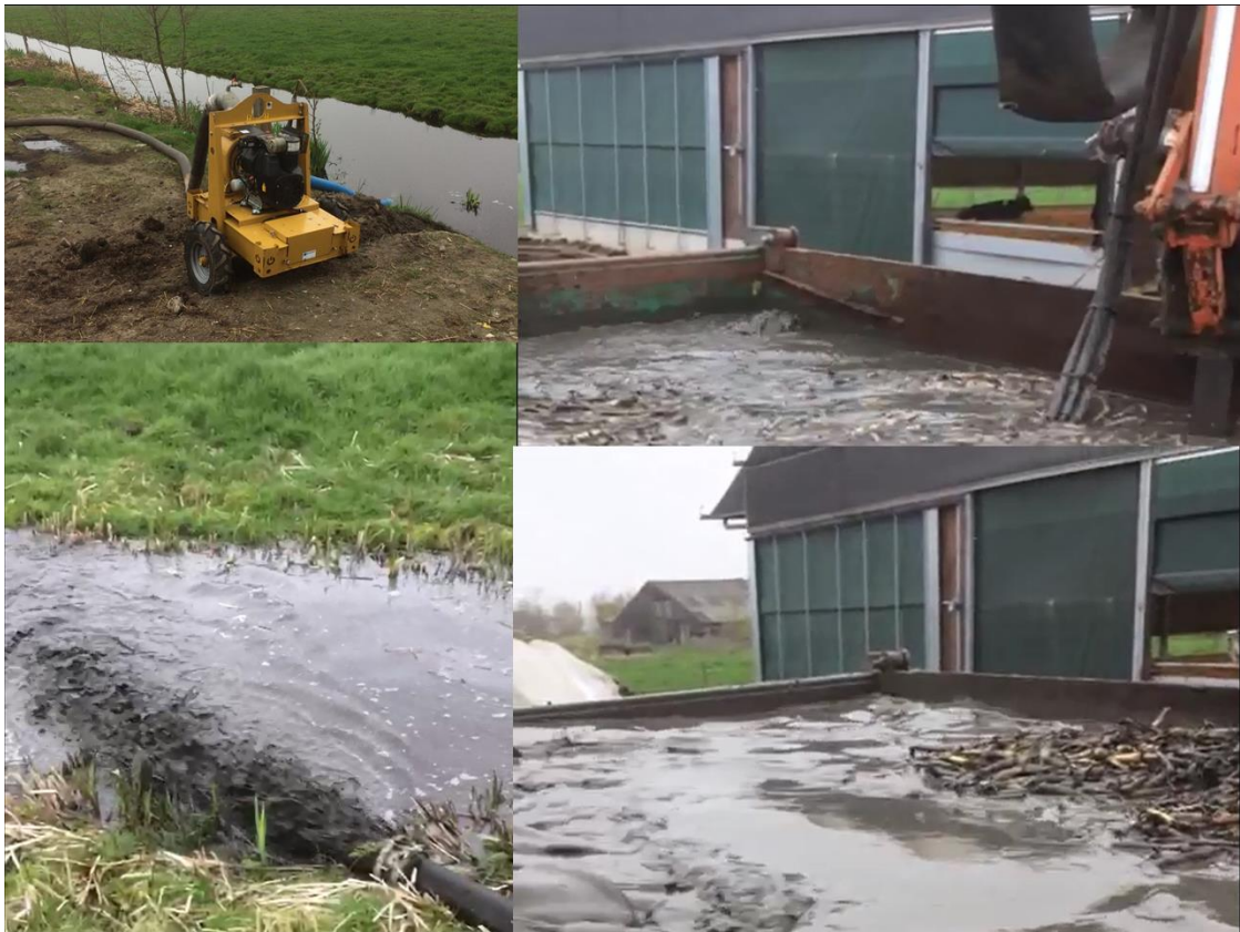
Afbeelding 5. Het maken van kleimelk in een container met behulp van een pomp aan een kraanarm. Eerst werd klei met slootwater geladen in een container, welke vervolgens met de baggerpomp tot kleimelk werden gemengd. Uiteindelijk werd het mengsel vanaf één punt over een lengte van ca. 170 m in een sloot gepompt.
