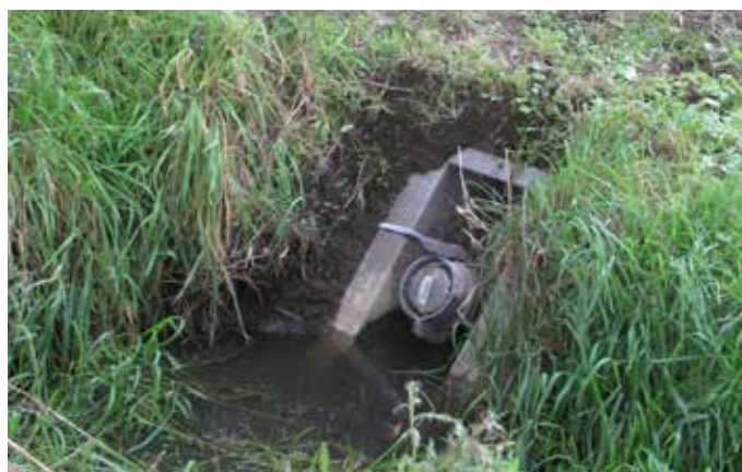
Peil in drainage kan gereguleerd worden door pijp omhoog of naar beneden te zetten.
